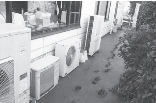
浸水のため廃棄処分となった室外機
