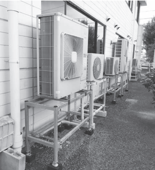
かさ上げた室外機
